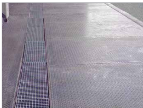
Ablaufrinne mit Gitterrost
